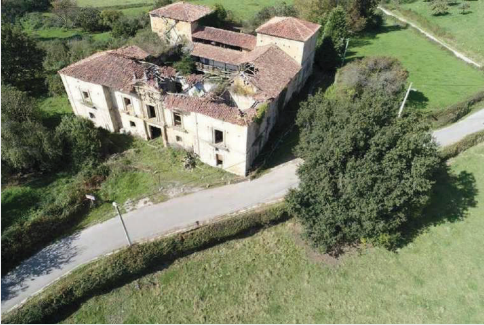
Imagen 5. Vista aérea de la pista asfaltada adosada a la fachada este del Palacio de la Torre de Celles previa al otorgamiento de la licencia de obras y conservación.
